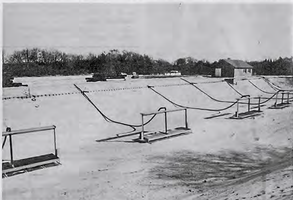
Bewegliche Lüfter warten auf die Inbetriebnahme. Durch sie wird Luftsauerstoff ins Abwasser geblasen.
