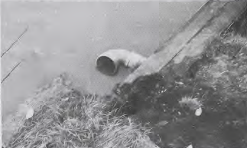
Über solch einfache Rohrverbindungen fließt das Abwasser von „Rieselfeld“ zu „Rieselfeld“. Bei zu großem Anfall werden Teilmengen über Gräben an einzelnen Feldern ohne Klärung vorbeigelenkt.
