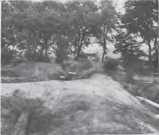
Primitiv angelegte Einlaufstutzen ragen ins erste Becken
